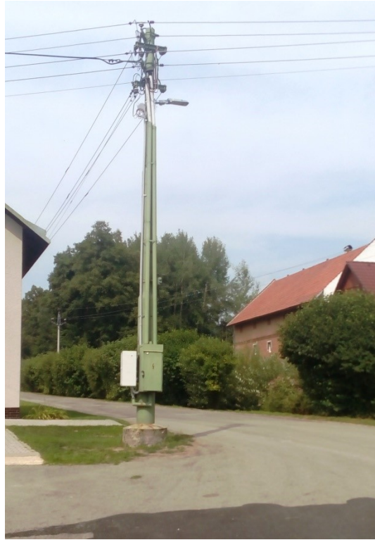
Nový stav lampa + rozvaděč
